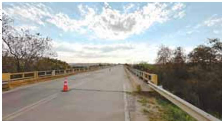
Estrutura que fica na estrada entre Rio Pardo e Cachoeira precisou ser recuperada
