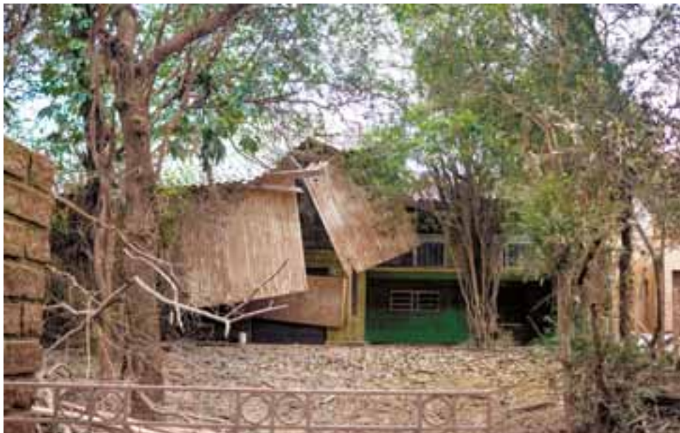
Telhados inteiros foram arrancados e levados pela força da água até se chocarem com outras construções
