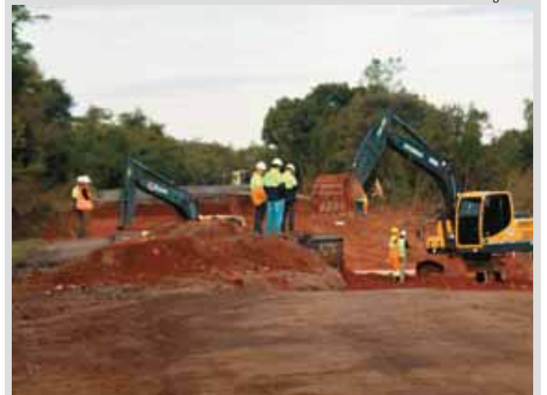
Um dos principais acessos à região, a RSC-287 foi danificada em diferentes pontos
