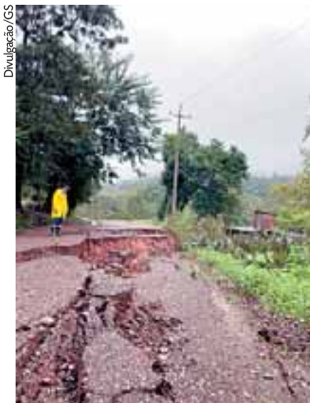
Estradas já começaram a ceder no município
