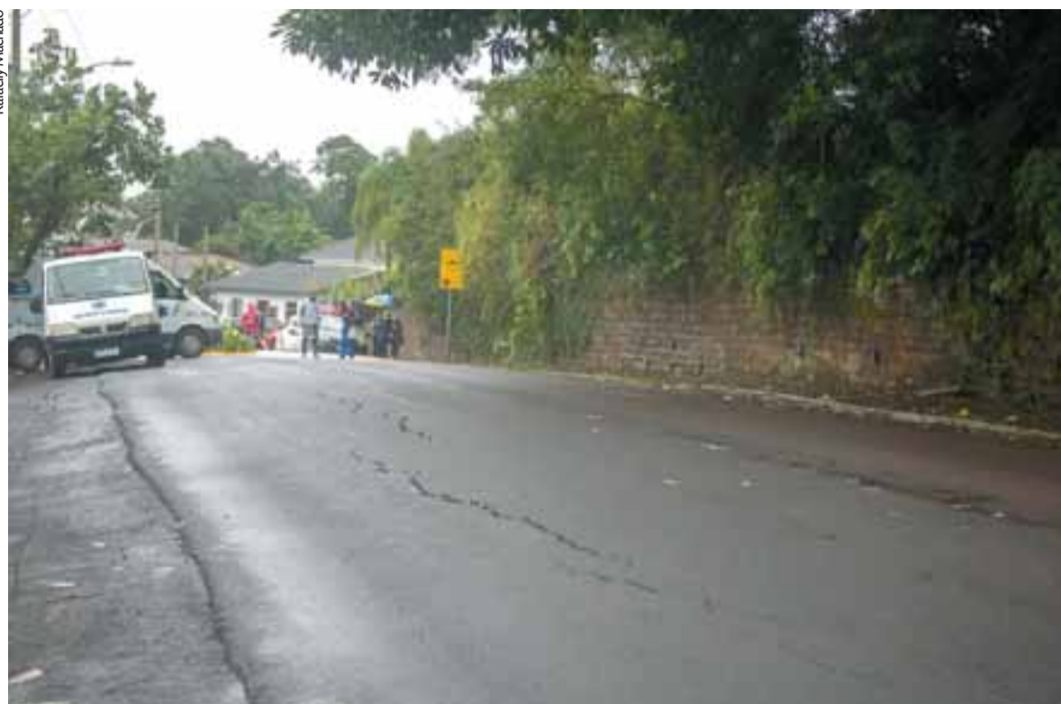
Rachaduras no asfalto da Rua Juca Werlang denunciam a movimentação do solo. Moradores tiveram que sair de casa às pressas
