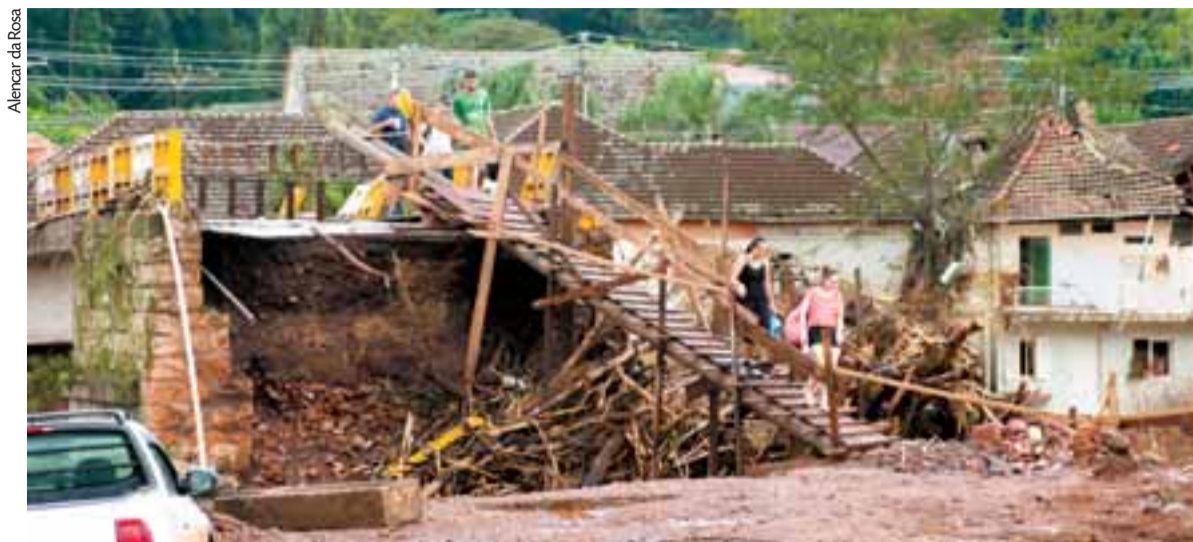
Vistorias em imóveis para verificar a situação das estruturas ocorrem junto com a limpeza e recuperação de casas e áreas públicas
