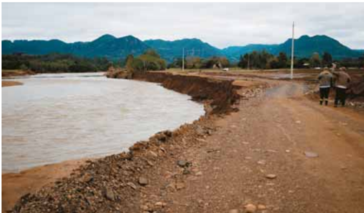
O desvio construído pelos moradores, em trecho com brita, está ameaçado pelo avanço no desmoronamento de terra nas margens
