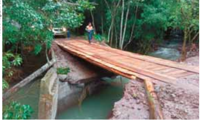
Onde antes havia pontes, estruturas provisórias estão garantindo a volta do trânsito
