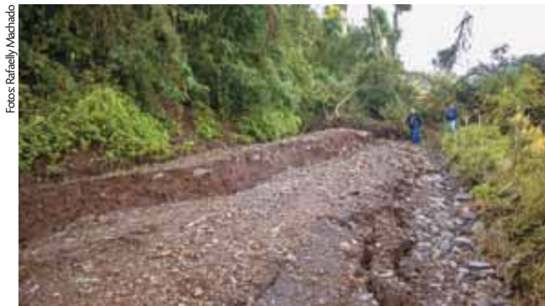
Estrada da localidade sofreu deslizamento e árvores caíram, atingindo a rede elétrica
