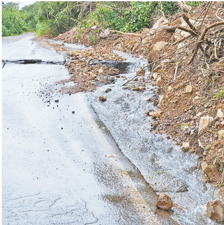
Brito também esteve em contato com o Governo e o Daer para cobrar solução às rachaduras em trecho próximo a Candelária
