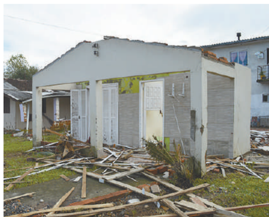
Fachada da casa onde poucas paredes ficaram em pé
