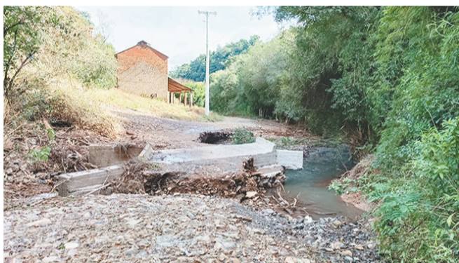
Ponte Linha Central danificada
