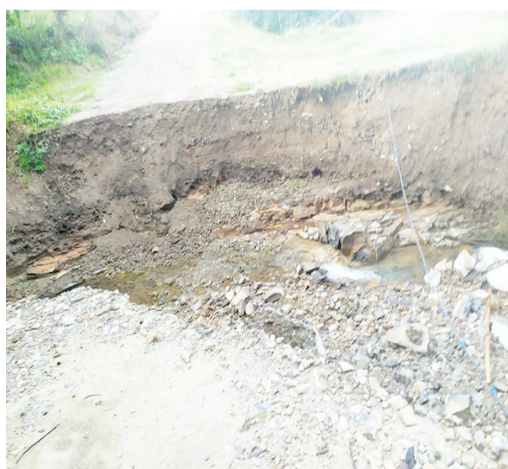
Bueiro em Linha Santa Cruz ficou danificado
