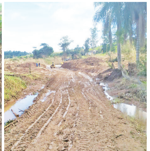
Ponte torta em Linha Santa Cruz passando pela limpeza
