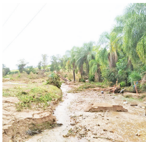
Ponte torta em Linha Santa Cruz antes da limpeza
